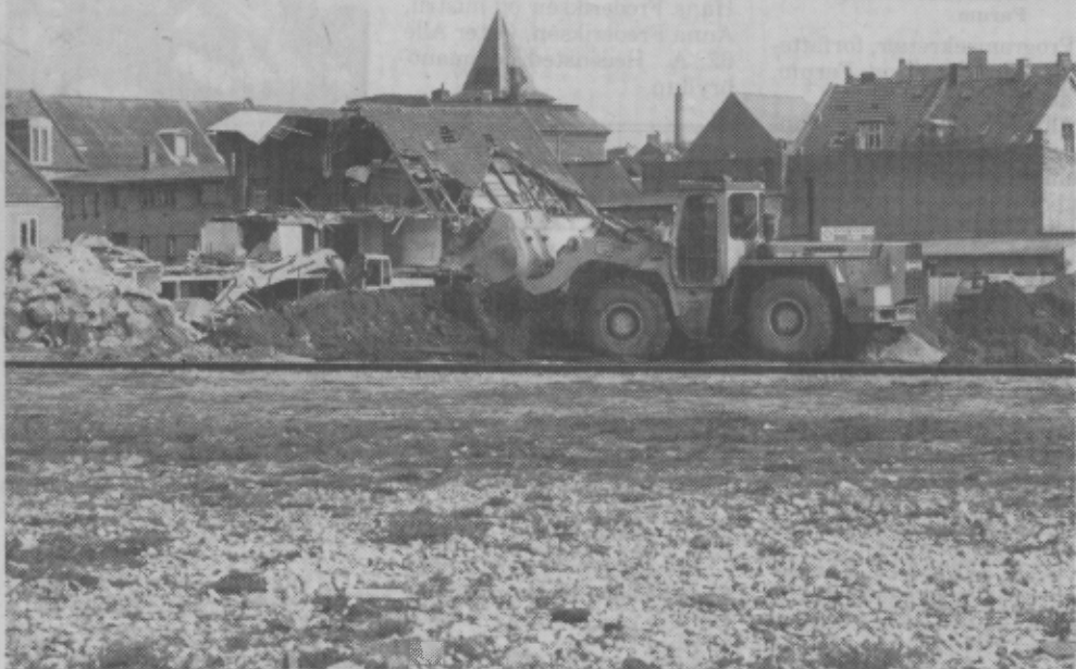
Entreprenørmaskinerne er gået i gang med jordarbejdet og nedramningen af pæle til det nye OBS-varehus ved Niels Gyldings Gade. (Foto: Povl Klavsen)
