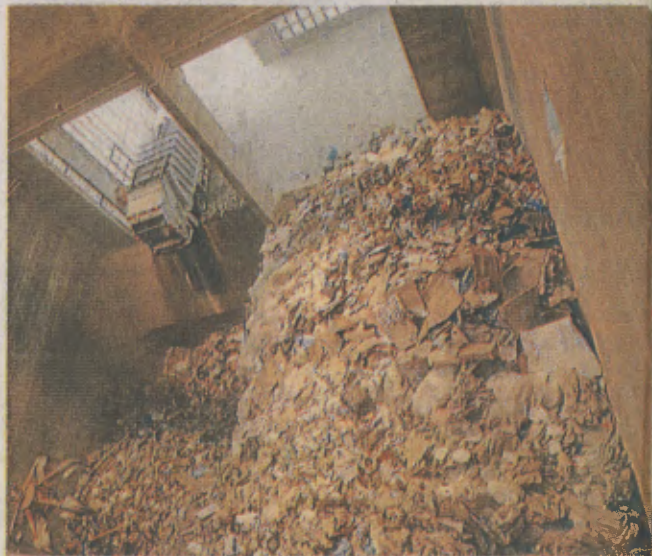
Der skal årligt hældes 70.000 ton affald ned i disse »trug«, hvorfra en kran med jævne mellemrum henter en portion til de to forbrændings-ovne.
