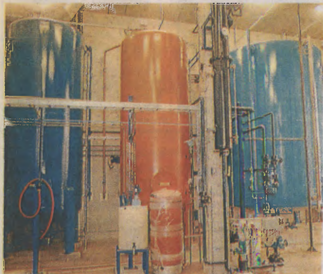
På kraftvarmeværket har man installeret eget vandværk, hvor der produceres afsaltet vand af meget høj kvalitet for at undgå tæring. Det bliver til 180 liter helt rent vand i døgn.
