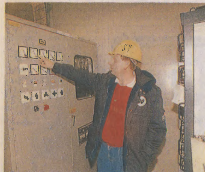
Selv om hele driften af værket styres via edb, kan vitale funktioner dog stadig kontrolleres på traditionelle paneler, og værket kan manuelt lukkes ned i en nødsituation.
