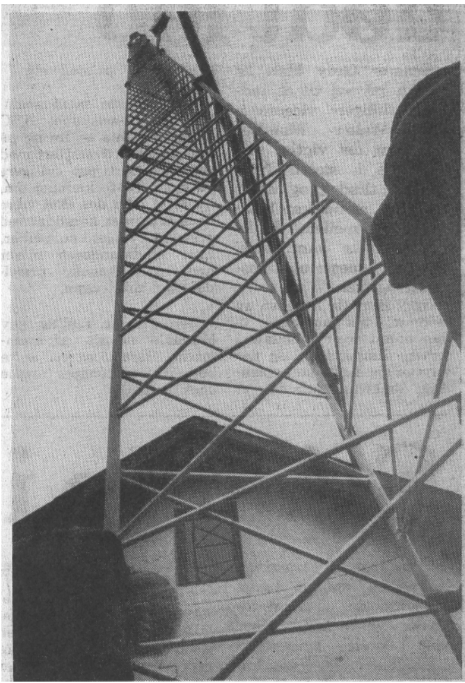
Torsdag kl. 14 stod tv-masten endelig op ved Horsens Discipel Højskole på Carolinelundsvej. Den er 30 meter høj, og antennen i toppen kan dække Horsens by med tv-signaler. (Foto: Lars Aare)
