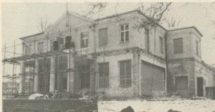
Omtrent denne udformning havde pavillonen ved opførelsen for næsten 150 år siden. Nu er verandaerne fjernet - tilbage er kun søjlepartiet med balkonen. Bygningen bliver smuk, når renoveringen efter sommerferien er færdig. (Foto Lene Sørensen)
