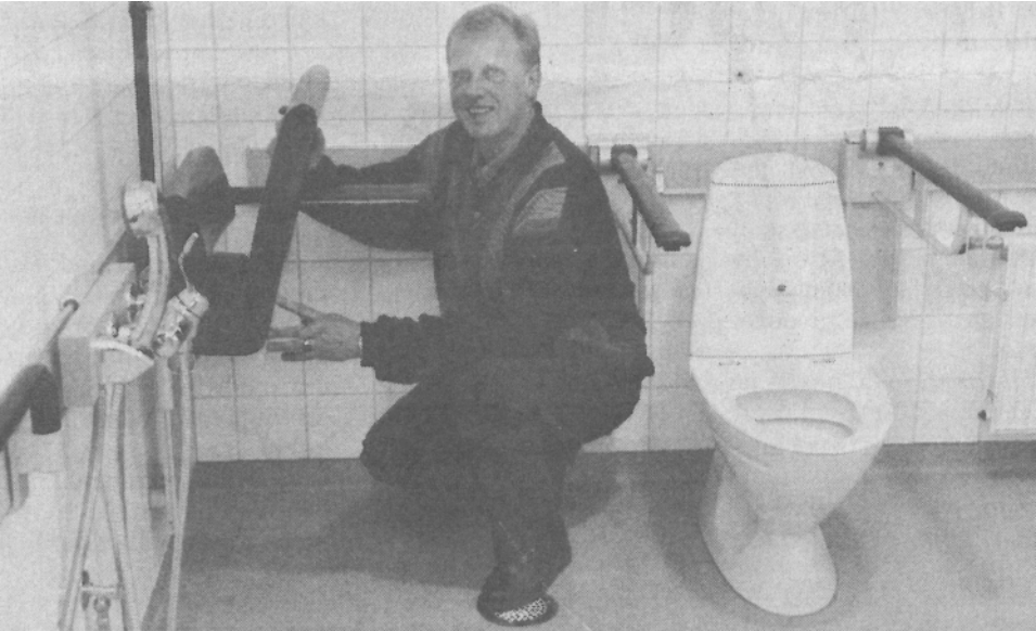
I alle badeværelser er der en fast skinne, som der kan monteres alverdens handicapudstyr. F.eks. denne badestol, som ældreboligplanlægger Finn Grøn bæk demonstrerer. Kommer der nye beboere, som ikke har brug for udstyret, piles det ned og lagges i depot. Tilbage er blot en grå skinne. (Foto: Martin Ravn)
