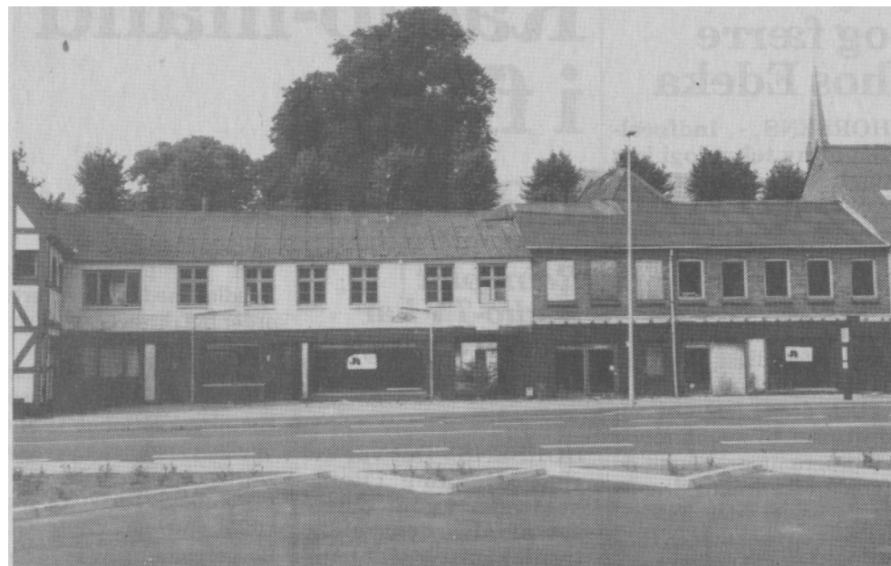
Disse to forfaldne ejendomme på Åboulevarden er medvirkende til, at politikerne i 1995 vil have området byfornyet, og det kan resultere i, at ejendommene skal rives ned. (Foto: Jan Høst-Aaris)
